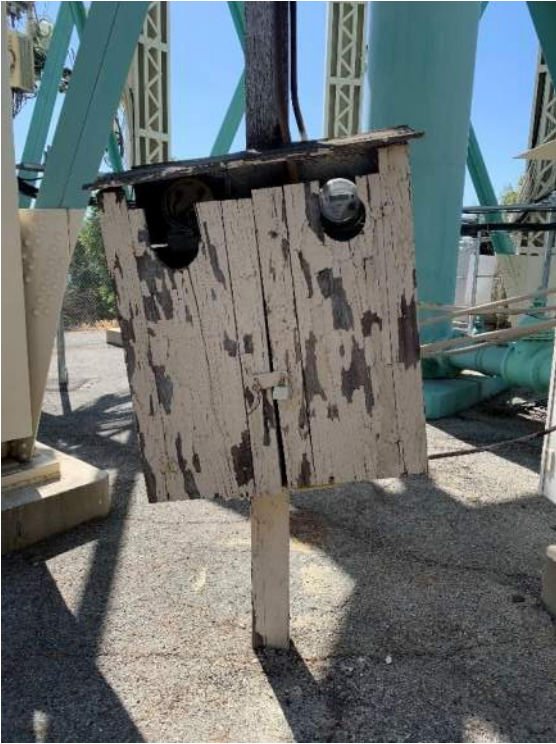
(Bil-5) Electrical Meter Box
