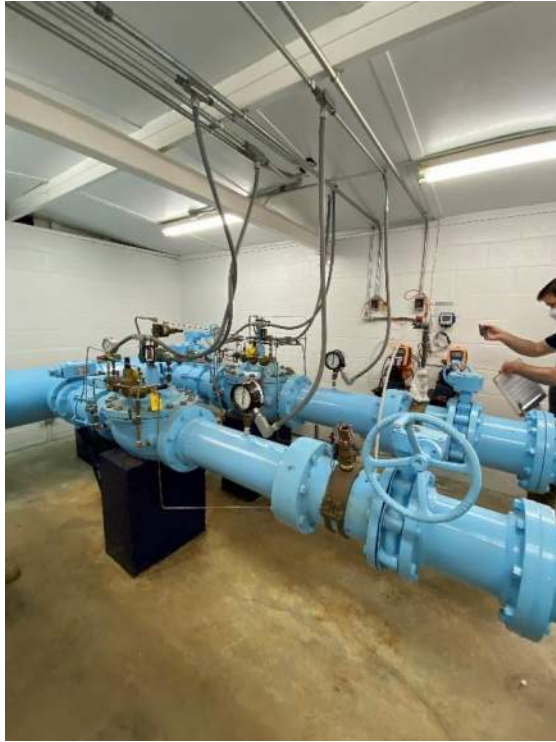
(Kol-19) Metering Assembly
