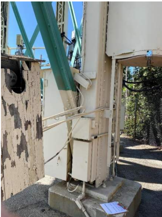
(Bil-14) Electrical Meter Box
