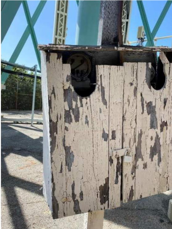
(Bil-13) Electrical Meter Box
